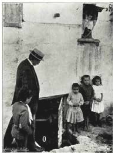
Fig. n.º 60 — Costas da fonte da rua Firmeza. O., indica um cano onde se juntam varias aguas immundas e que coincide justamente com o oculo de abobada onde se veem abundantes infiltrações.
